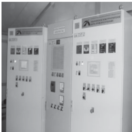
Рис. 4. Стойки системы автоматического управления СУГ-1М
