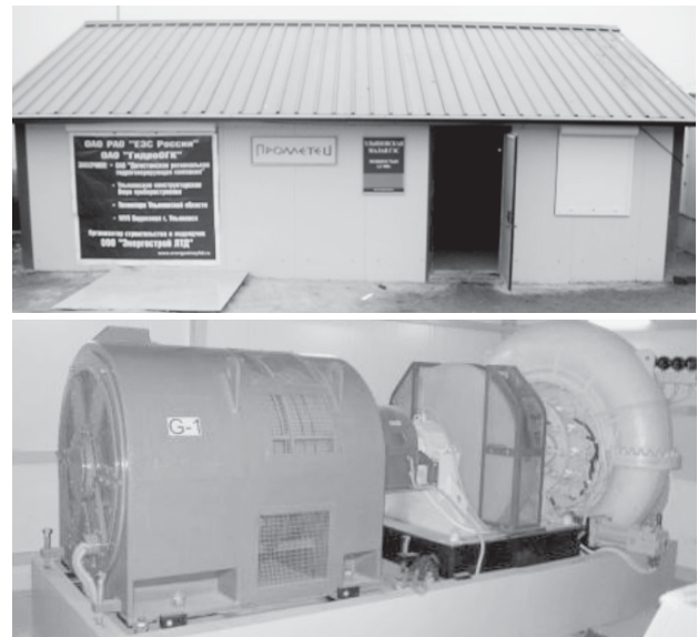
Рис. 3. Здание станционного узла и гидроагрегаты с турбиной типа РО 230/791-Г-50
