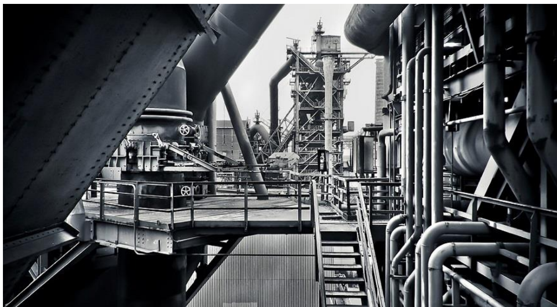
Водород может перемещаться и по стальным трубам, но вот высокое давление при этом нежелательно
